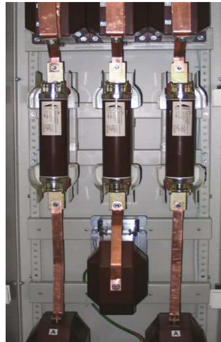
Příklad připojení ve vnitřním rozváděči:
